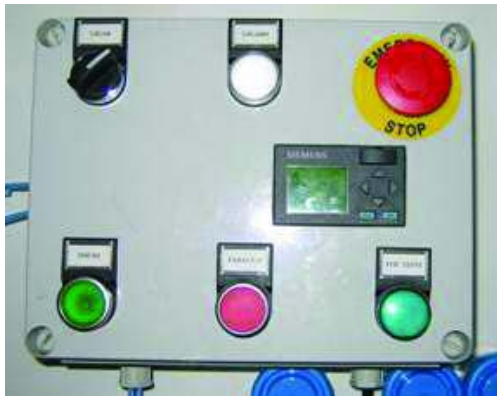
Figura 2 - Central de comando
